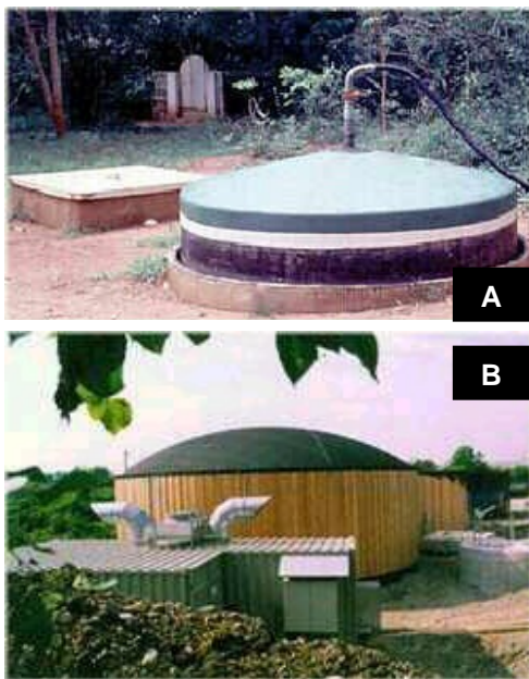
Figura 2: Digestor de uso doméstico (A) e industrial (B). ( http://www.cubasolar.cu/ )
